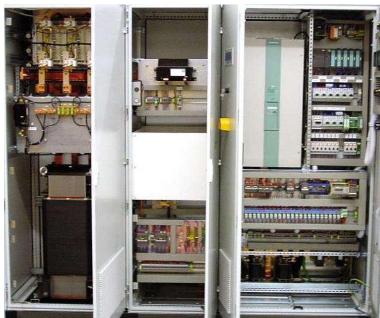
USK_200kW: Untersynchrone Stromrichter-kaskade für 2000kW Pumpenantrieb in einem Wasserwerk.
