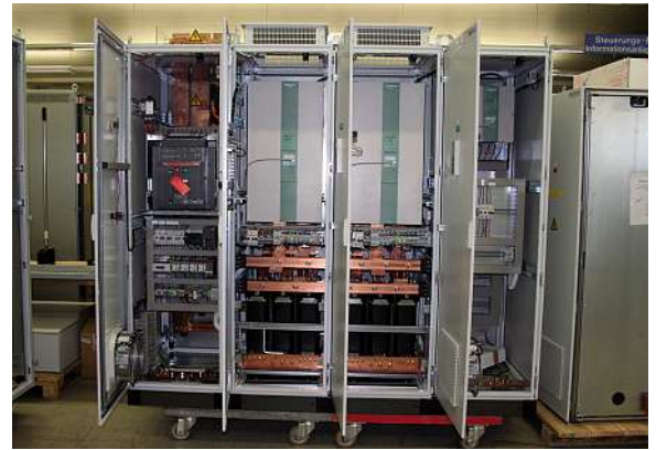
Bild 2: Für die Steuerungs- und Regelungstechnik existieren heute Lösungen, die kompakter, preiswerter, intelligenter und leistungsfähiger sind als noch vor wenigen Jahren.
