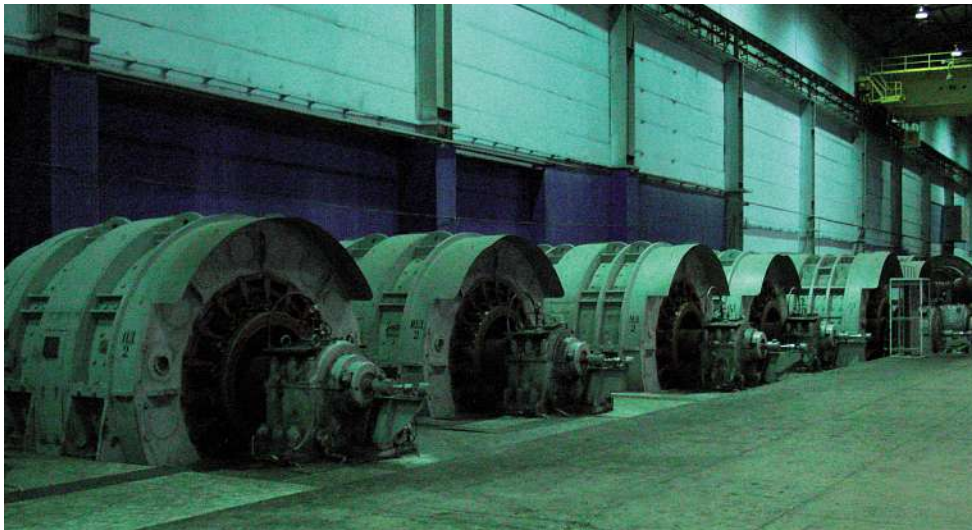
Bild 1: Elektromotore sind auch nach langjährigem Einsatz häufig noch voll funktionstüchtig. Veraltete Steuerungstechnik und Elektronik kann durch Retrofit wieder auf den aktuellen Stand gebracht werden.
