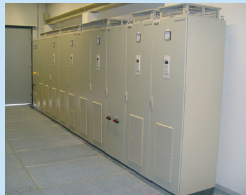
Die gesamte Schaltschrankbreite für die IGBT-Einspeiseeinheit und die vier Motorwechselrichter beträgt nur 6 Meter
