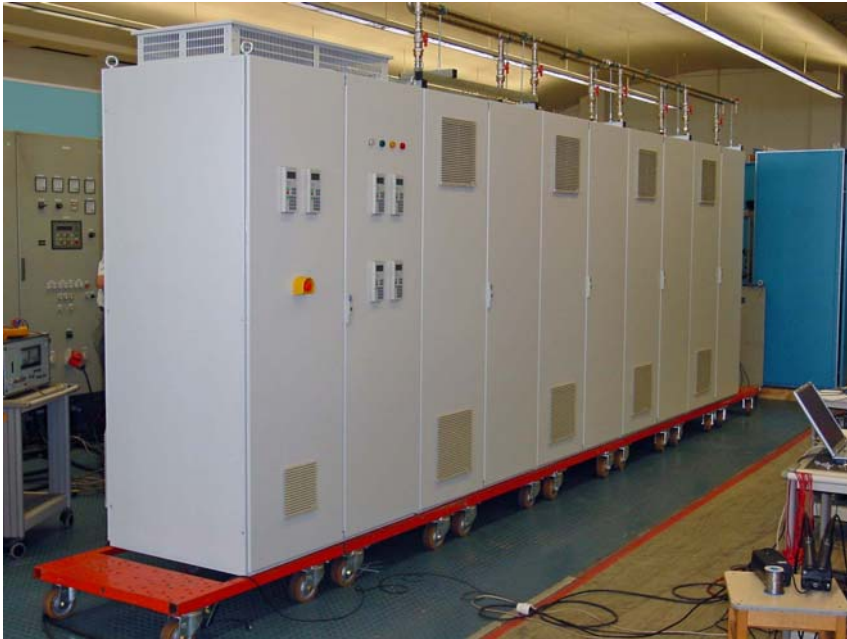
Gesamtansicht der Stromrichteranlage
