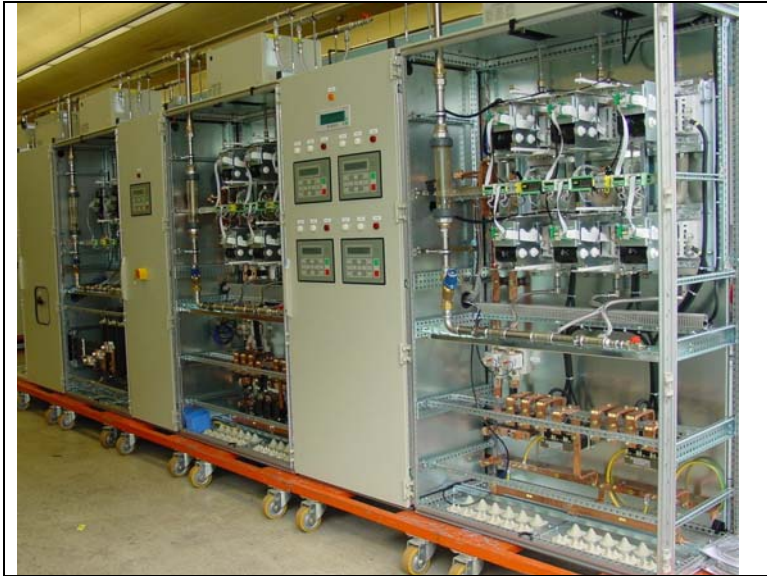
Foto: Wasserge- kühlter Umrichter 4x160 kW
