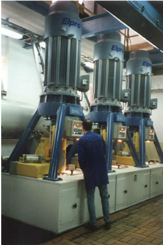
Zentrifuge – Kontrolle der Chargenablauf-Steuerung nach erfolgter Inbetriebnahme der Zentrifuge
