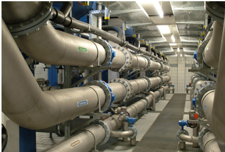
Bild: Rohrleitungen der Druckerhöhungsanlage Hassloch
