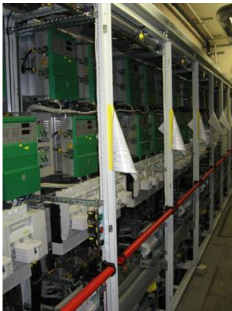
Blick in den Schaltraum – Gerüste mit Stromrichtergeräten
